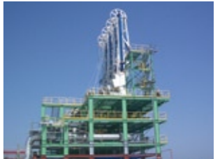
LNG loading arm
