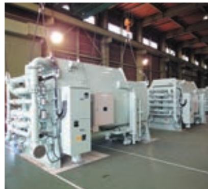
事業譲渡を受けた吸着式冷凍機
