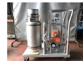
可搬タンク、付臭装置
